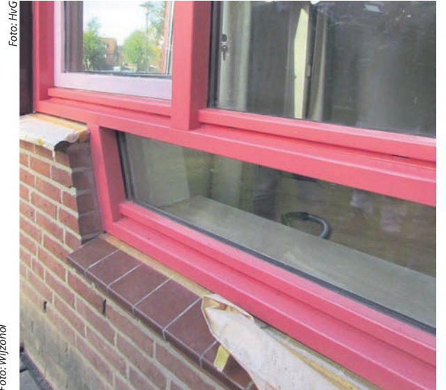
Mede door deze detaillering is gekozen voor afbranden en niet voor schuren
